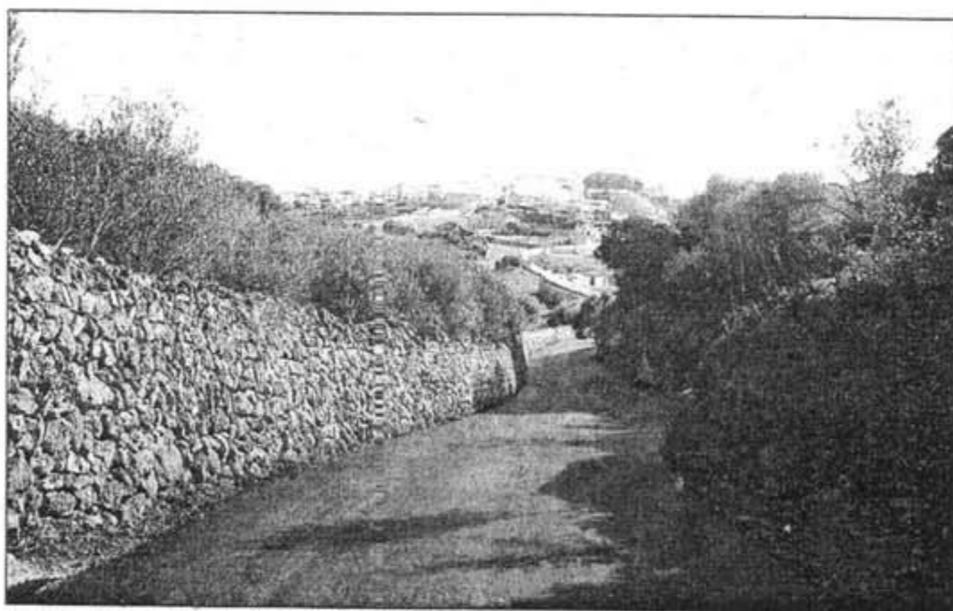
Estado en el que ha quedado la vía rural entre la calle Ciutadella de Alaior y la general.
