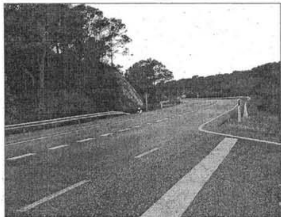
Aseguran que la carretera está colapsada.
