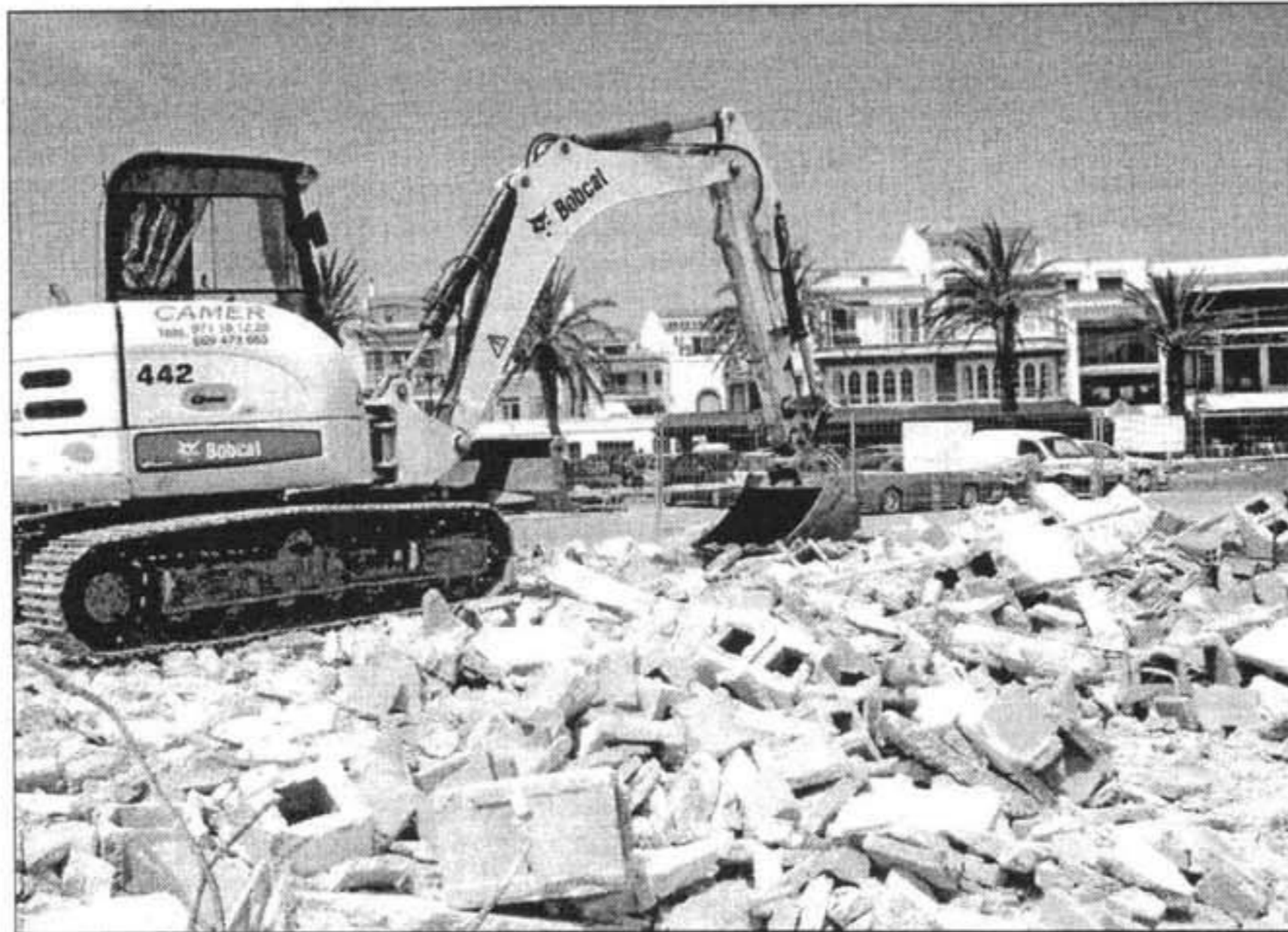
DERRIBO. Ferrovial Agromán inició ayer las obras que se prolongarán durante un mes
