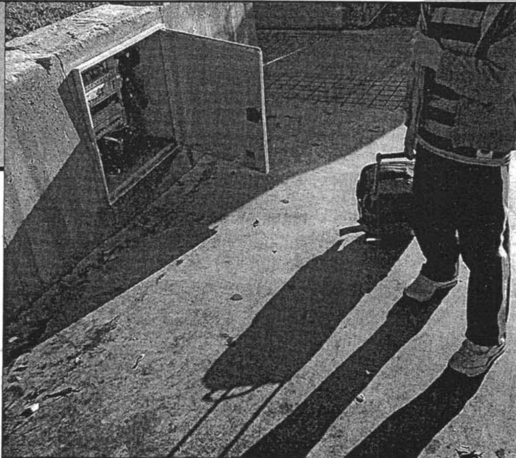
ARMARIO. Se encuentra al descubierto ya que la puerta está estropeada y no es posible cerrarla
